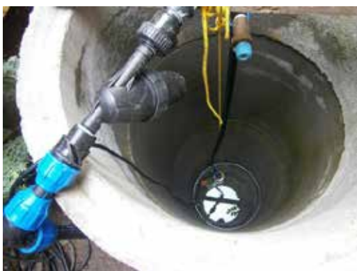
Čerpadlo zavlažovacieho systému
