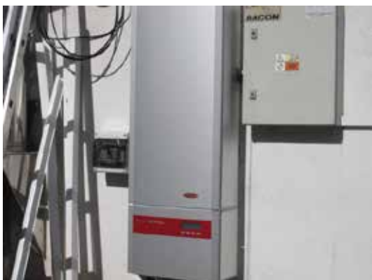
Časť fotovoltaického systému
